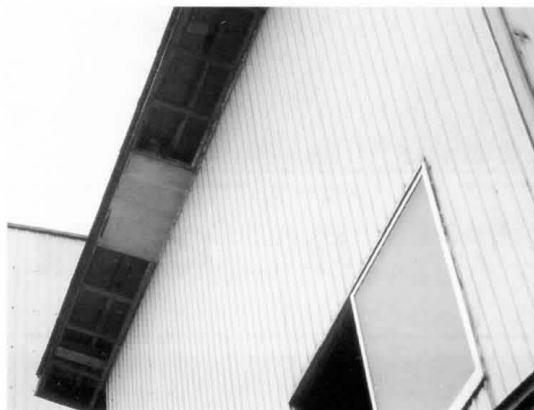
図1. 営巣した軒裏(白いスレート部分)
